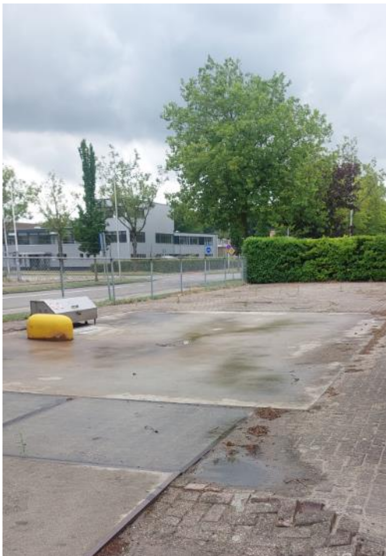
figuur 2: Vloeistofdichte vloer op het buitenterrein.
