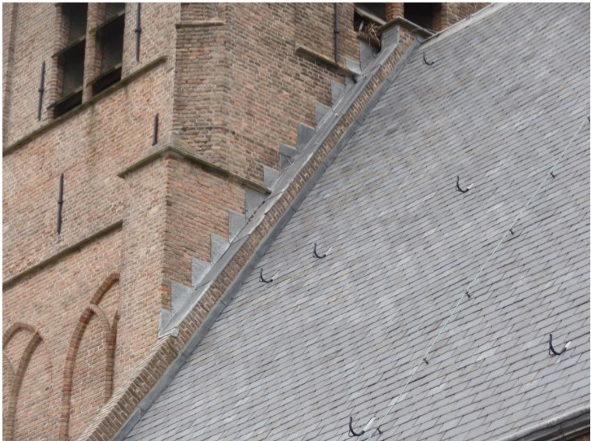
Slechte detaillering loodwerk t.p.v. aansluiting toren op kerkzaal.
