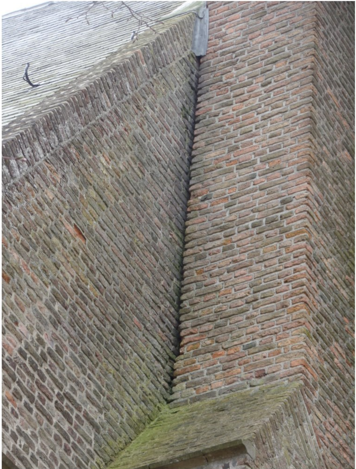
Naad tussen kerktoren en kerkzaal.
