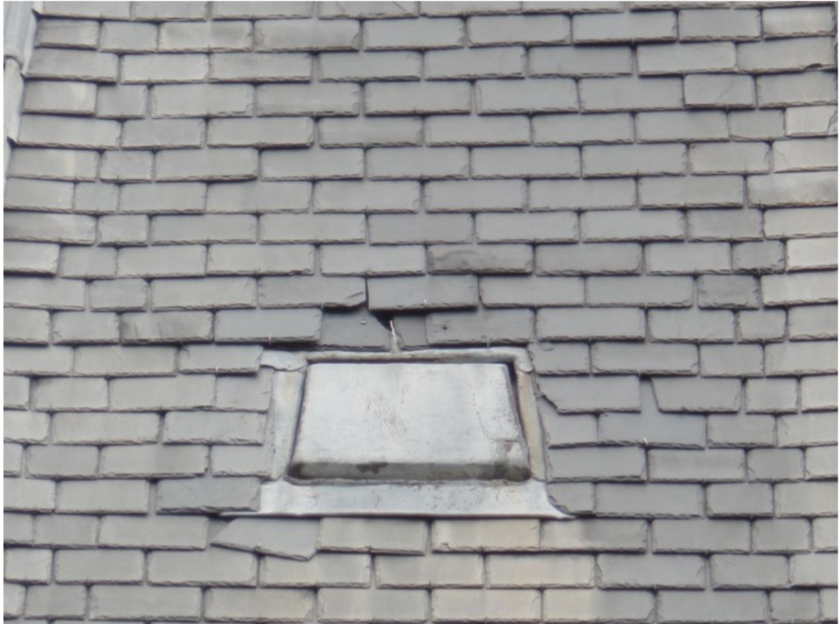
Kapotte en verzakte leien en matig loodwerk vlaggenluik.
