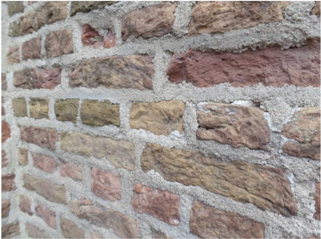
Cementvoegwerk dat niet verdiept is aangebracht, naden tussen baksteen en voeg.
