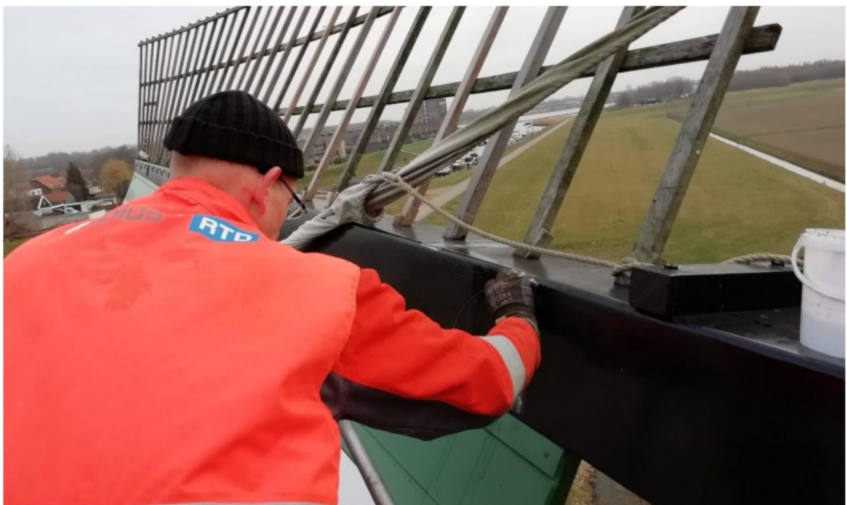
Afb.7: In 2018 heeft ApplusRTD onderzoek verricht naar de conditie van de lasnaden. Hierbij werden geen vermoeiingsscheuren aangetroffen maar wel diverse lasindicaties. Restauratie Werkplaats Schiedam heeft n.a.v. deze resultaten geadviseerd de roeden in ca. 5 jaar te vervangen.
