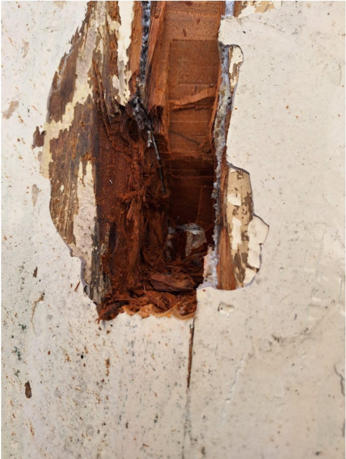
Afb.14: Close-up van de houtrotaantasting in de staartbalk. Het hout is tot in de kern vochtig en door houtrot aangetast. Eerdere herstellingen uit het verleden zijn opnieuw aangetast.
