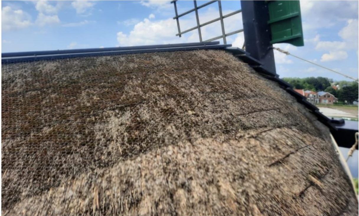
Afb.11: Close-up van het rietdek. Op diverse plaatsen zijn (oude) herstellingen zichtbaar.
