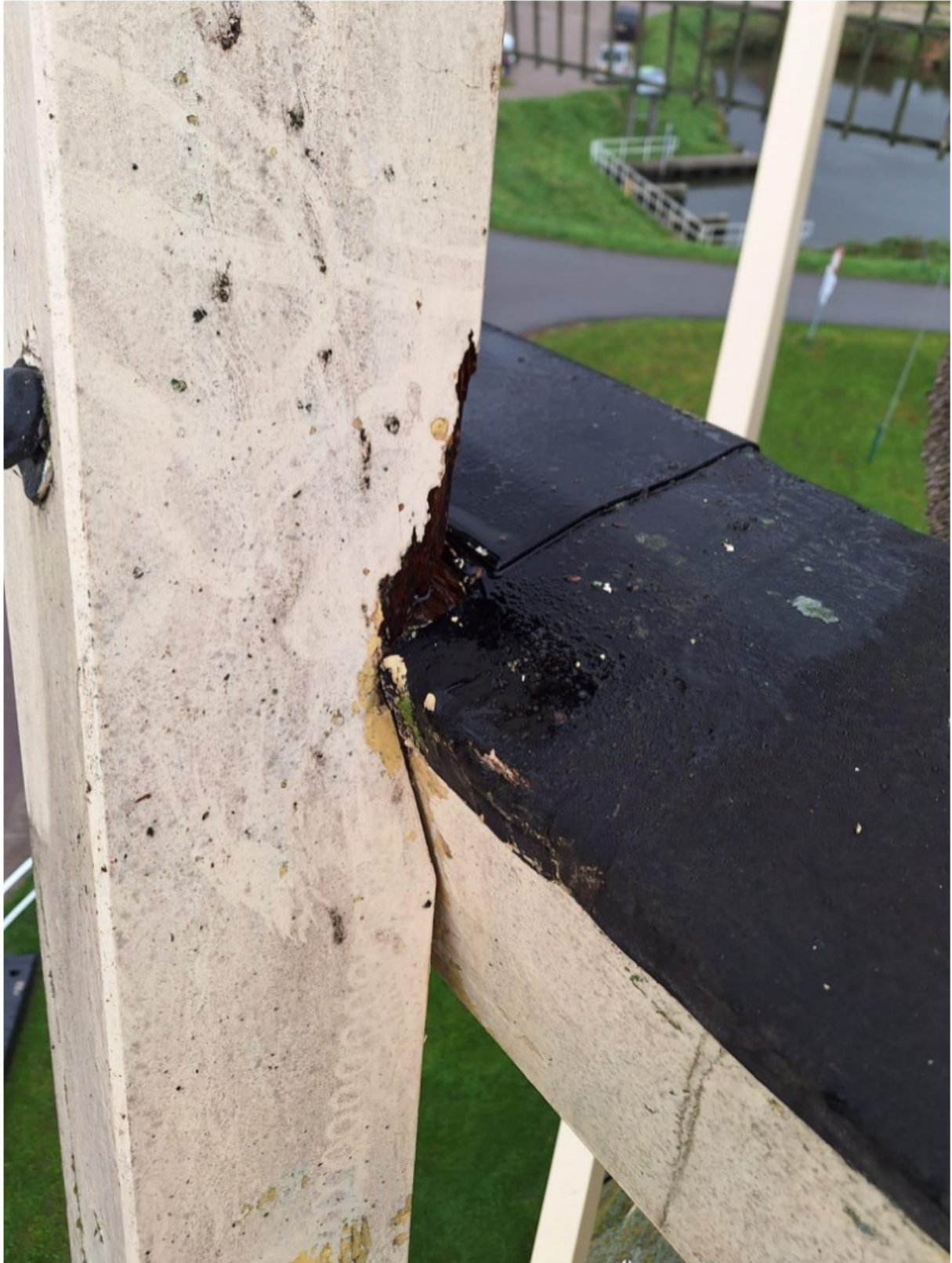
Afb.16: Close-up van het houtrot in de linker korte schoor. Ook in de kop van de korte spruit heeft de houtrot zich oppervlakkig ontwikkeld.
