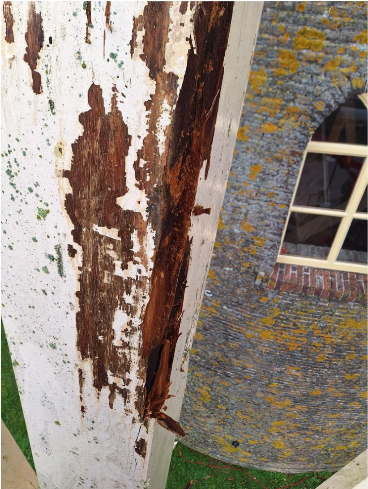
Afb.13: De staartbalk is verzadigd met vocht en over de volledige lengte door houtrot aangetast. Hierdoor is herstel van het aangetaste hout en het schilderwerk niet meer mogelijk.
