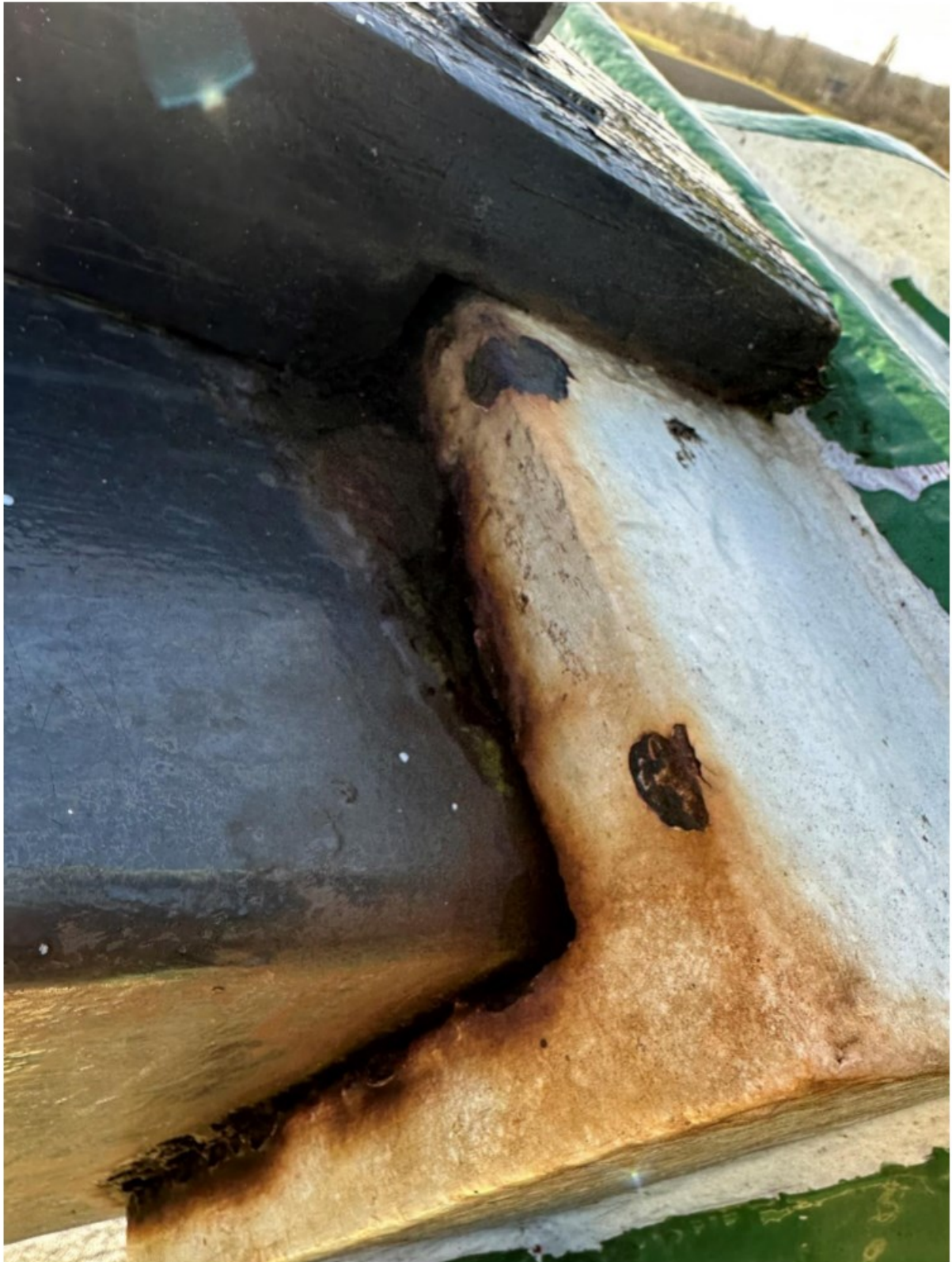
Afb.5: De roeden hebben in de askop sterk te lijden van sterke putroestanstasting. De plaatdikte van de roeden is hier ingeteerd.
