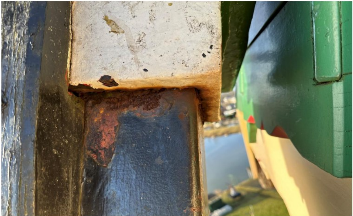
Afb.6: Zicht op de roestaantasing van de roede in de askop.
