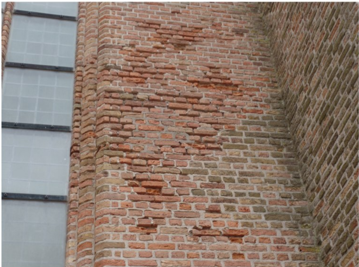
Vorstschade in westgevel
