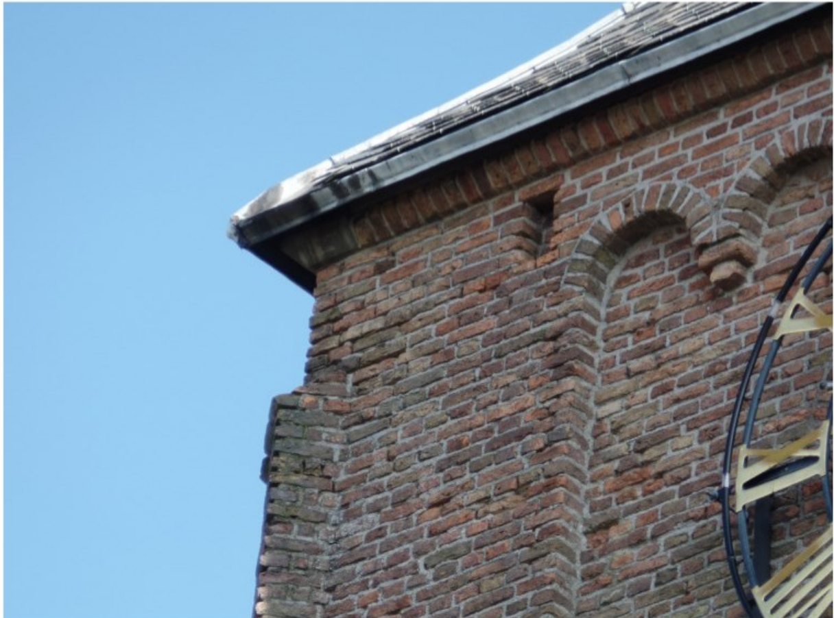
Schadebeeld zichtbaar tot aan de spits.
