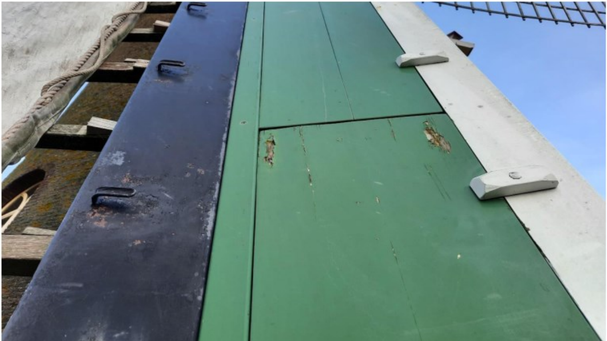
Afb.4: In de afgelopen jaren is sober herstel uitgevoerd aan het gevlucht om de draaivaardigheid te waarborgen. Waar mogelijk zullen onderdelen worden hergebruikt, waaronder de middelste en bovenste windborden.
