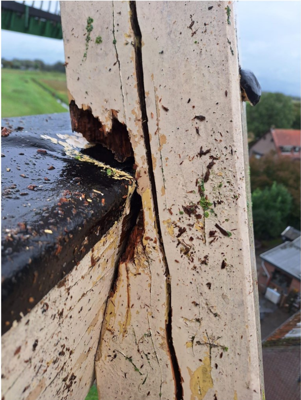
Afb.15: Close-up van de rechter korte schoor. Beide schoren (lariks) zijn door houtrot aangetast. Op de oplegging/verbinding met de korte spruit heeft de aantasting zich in de spruit verder ontwikkeld. De korte schoren dienen te worden vervangen, de spruitkop hersteld.
