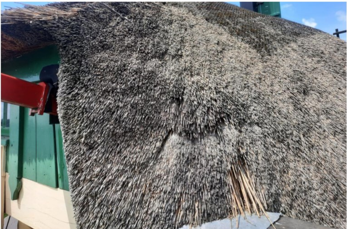
Afb.12: Close-up van het rietdek. Het rietdek is gedegradieerd en toe aan algehele vervanging.
